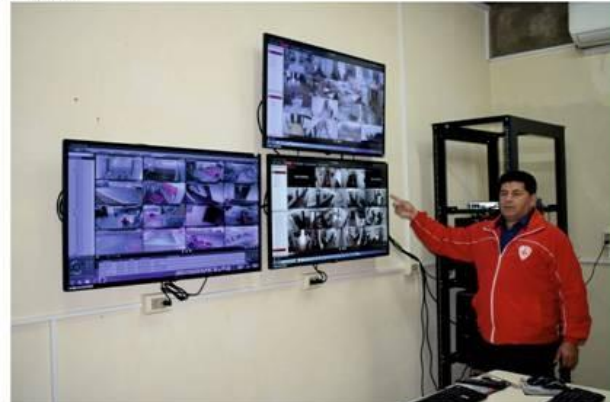
La sala de monitoreo cuenta con más de 150 cámaras CCTV. El jefe de seguridad Claudio Quintana observa atentamente la cobertura interna y externa del Colegio
